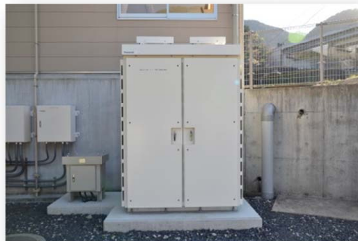
リチウムイオン蓄電池 20kWh 1基
